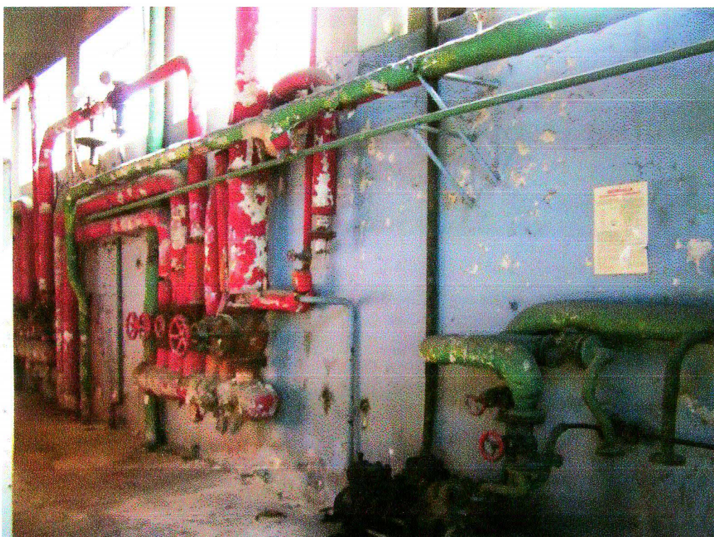
Rury instalacji technologicznej
