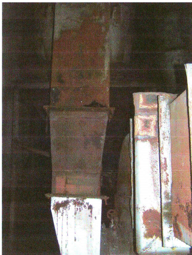
Rurociągi instalacji odpylającej
