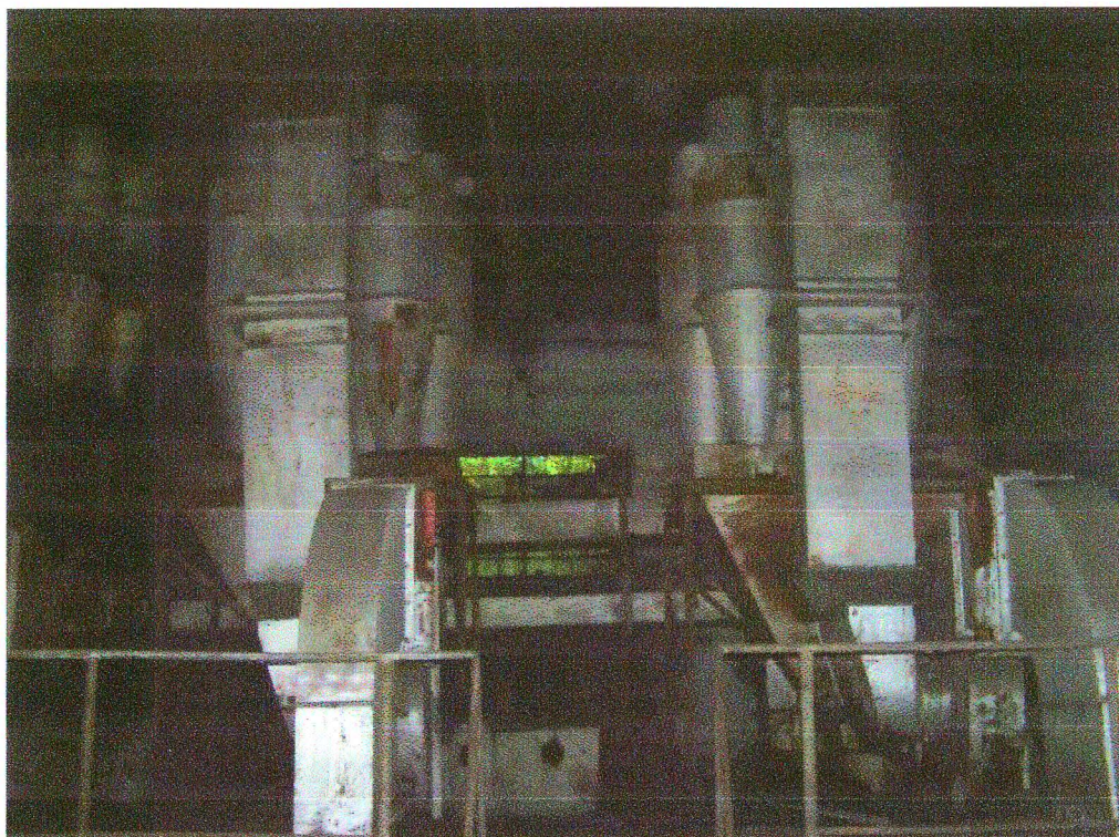
Instalacja odpylająca-widok ogólny
