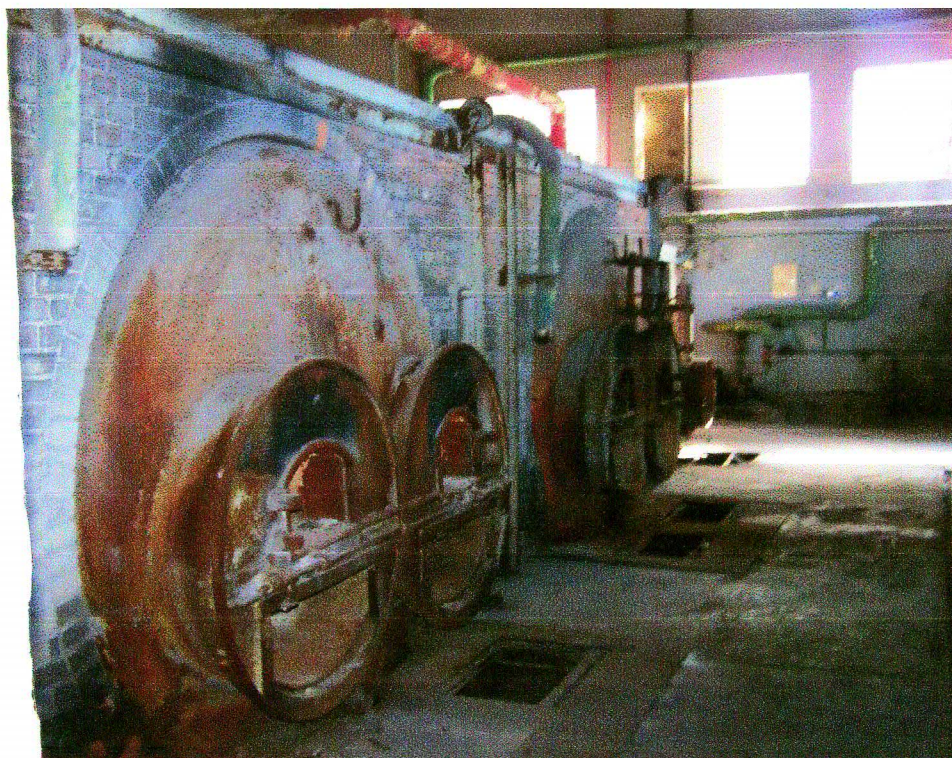
Kotły widok ogólny
